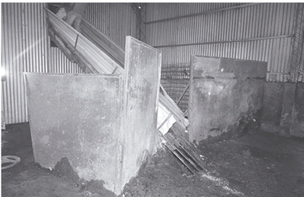
Graves daños dejó el incendio sucedido en la Planta de Reciclado. Se investigan las causas del siniestro. Foto De Sogots.
