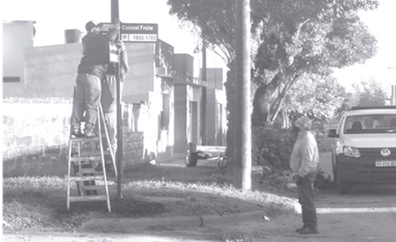
Personal municipal trabaja en la colocación de los indicadores de calles, en la foto Stgo. del Estero y Cnel. Freire. Foto De Sogos.
