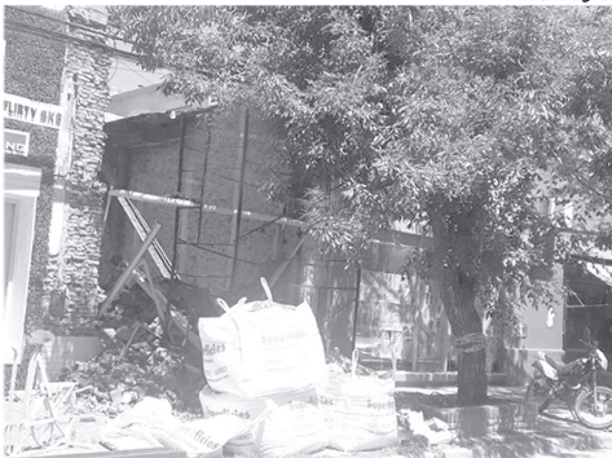
La elocuente imagen muestra cómo quedó el lugar del local céntrico después del derrumbe, donde se encontraban trabajando dos operarios. Foto De Sogos.
