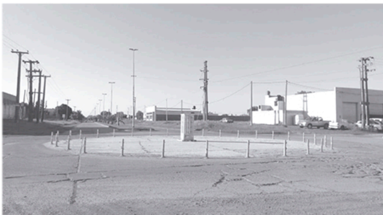
Vista de la provisoria rotonda de Urquiza y Agustín Alvarez que presenta importante deterioro en el pavimento. Foto De Sogós.
