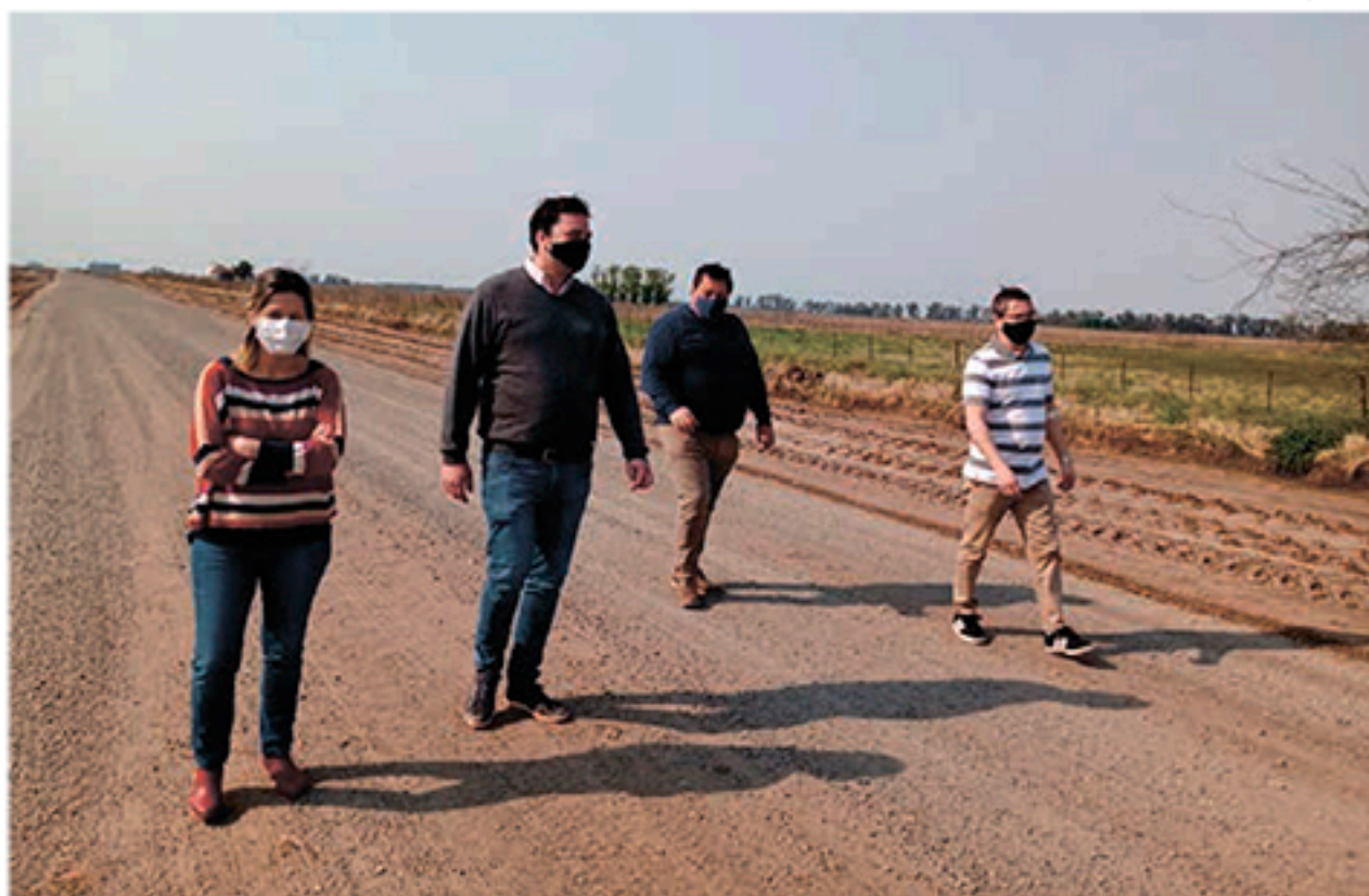
Autoridades recorren uno de los tramos del suelo estabilizado con pedregullo del acceso a Patricios. Prensa Municipal.
