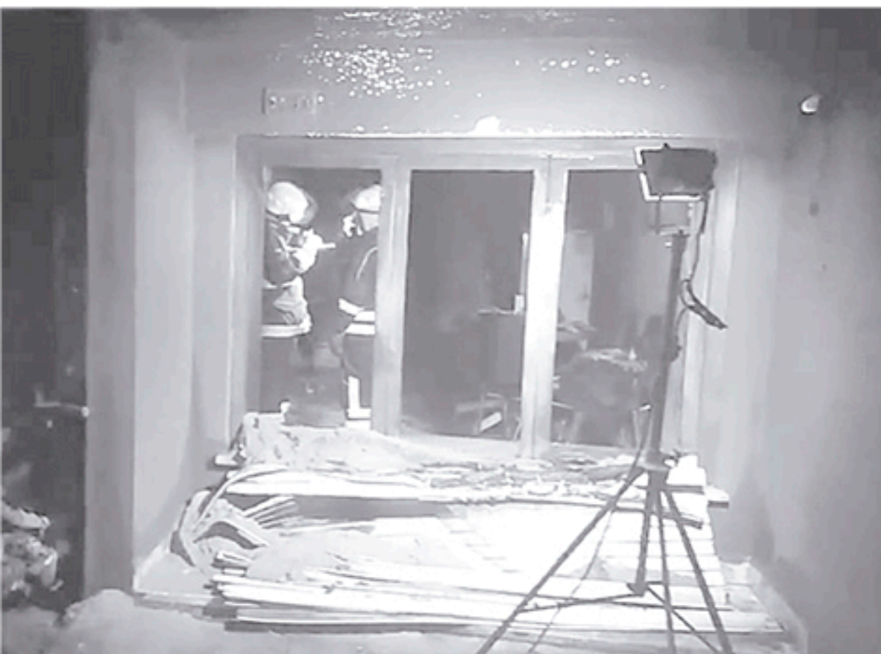
Imagen de la vivienda que sufrió importantes daños materiales. Foto: DeSogos.
