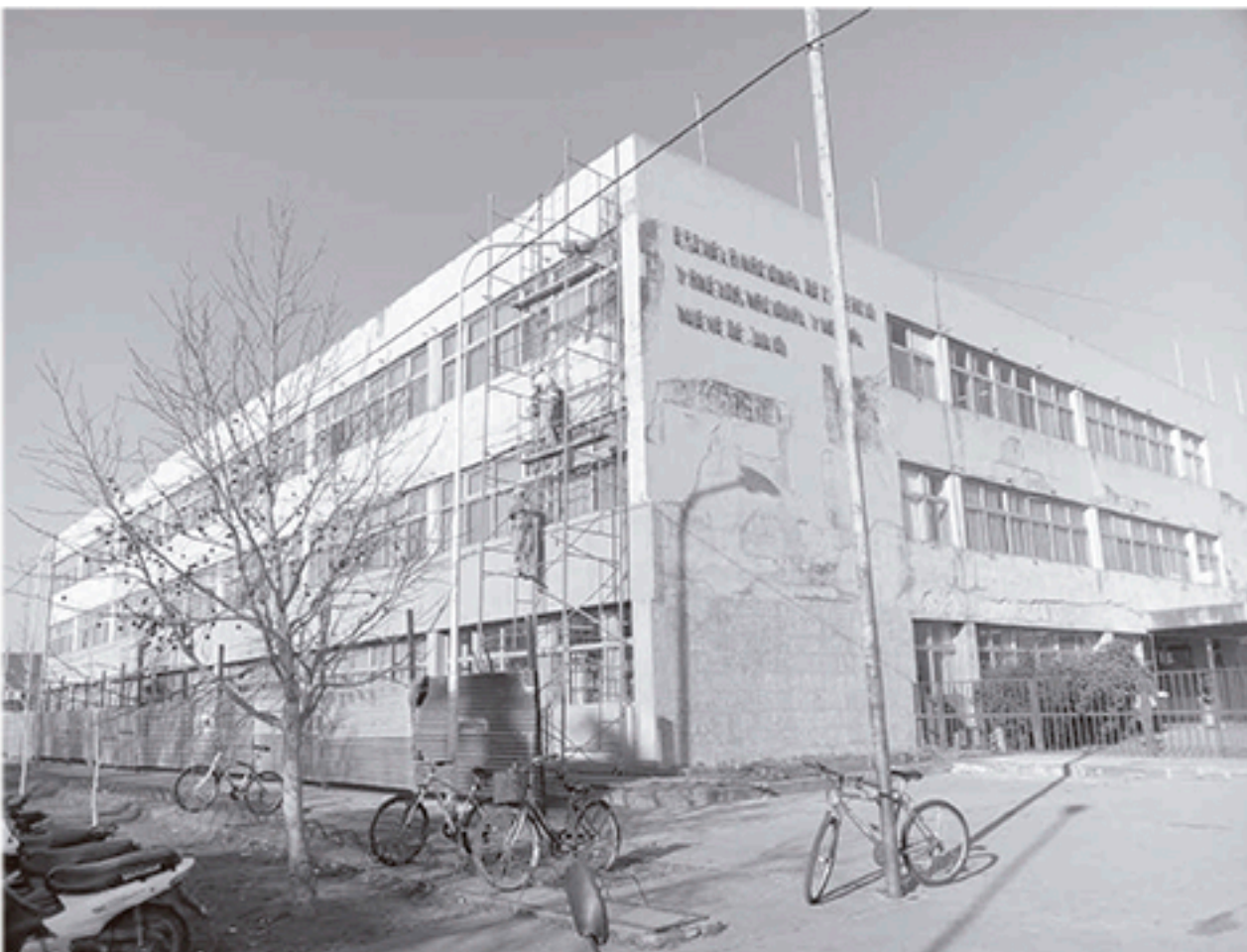
Vista del frente del edificio muy deteriorado que será refaccionado en varias etapas. Foto De Sogós.
