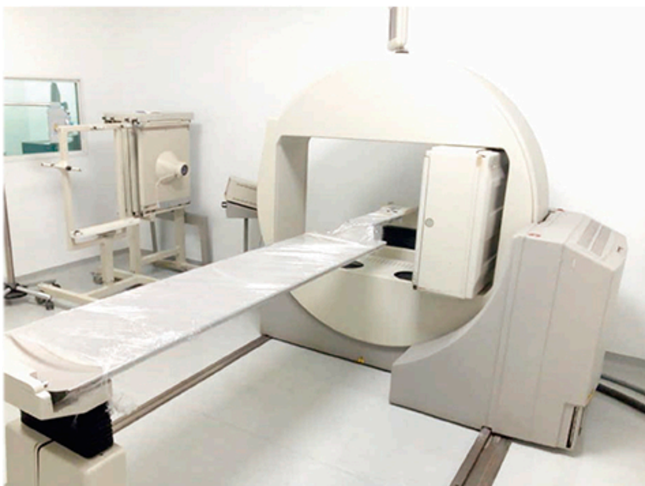
Aparatología de última generación instalada en el nuevo centro de salud. Foto: DeSogos.
