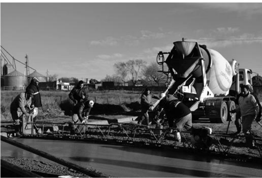
Vista de los trabajos que se llevan adelante en la continuación de calle San Juan. Foto Prensa Municipal.
