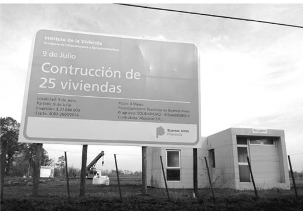
Como muestra la imagen fotográfica ya se trabaja en la instalación de las 25 viviendas.
