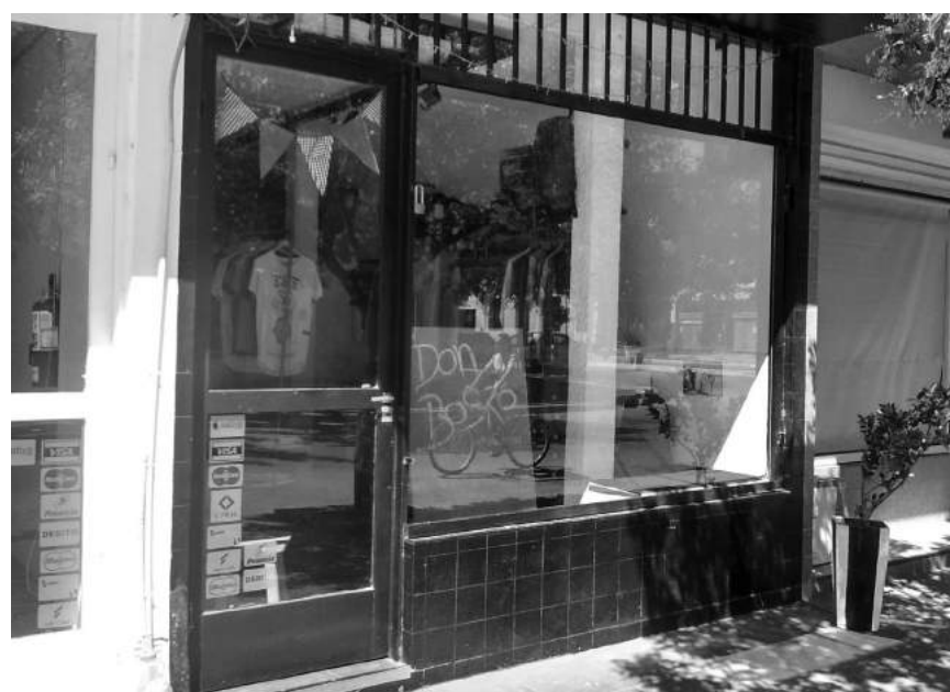
Estado en el que quedó el frente del comercio. Foto: DeSogos.
