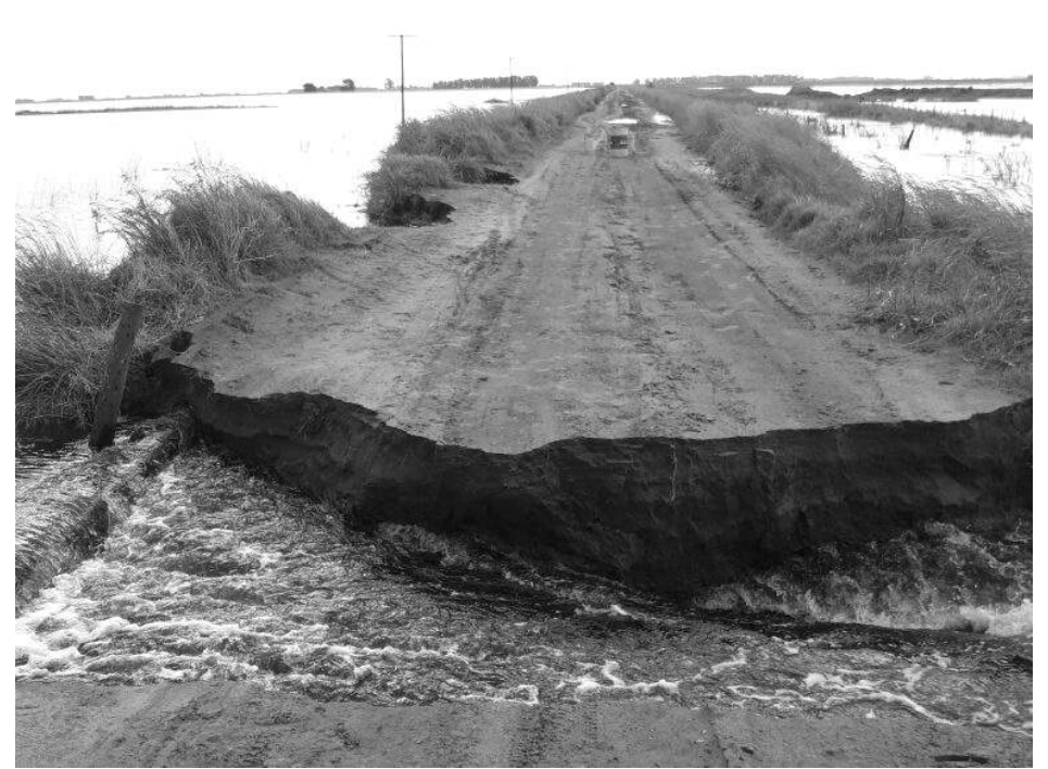
El caudal de agua con fuerte corriente arrasó con las alcantarillas del camino a Del Valle.
