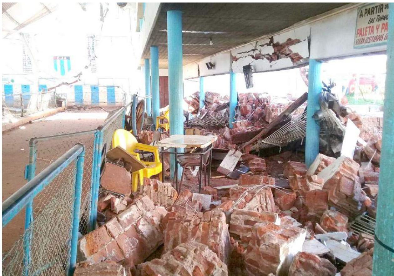
El gimnasio y la cancha de bochas del Club Juventud Alsina, contiguos a la discoteca Cascanuevecas, quedaron destruidos por el temporal.
