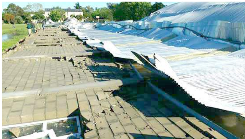
El gimnasio del CEF se desplomó por completo.
