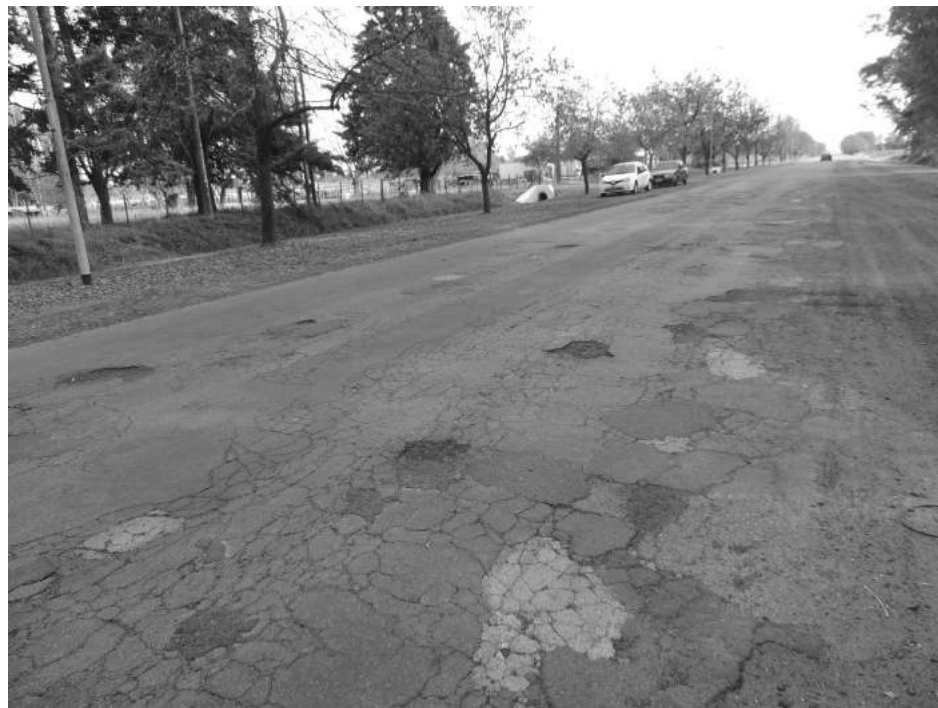
Estado en que se encuentra desde hace varios años el acceso a la localidad.
