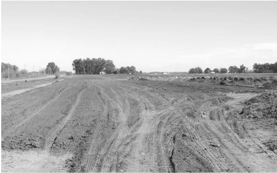
Vista de los trabajos realizados en los terrenos en la mañana de ayer.
