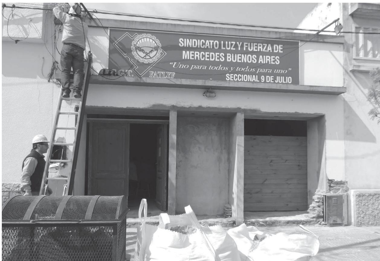
Vista del frente de la sede del sindicato que está siendo refaccionada. Foto: DeSogós.
