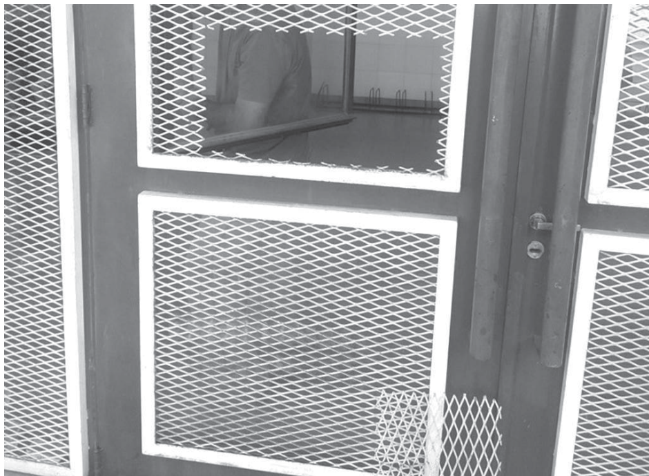
Vista de la rotura de la reja protectora, muy prolijamente cortada.
