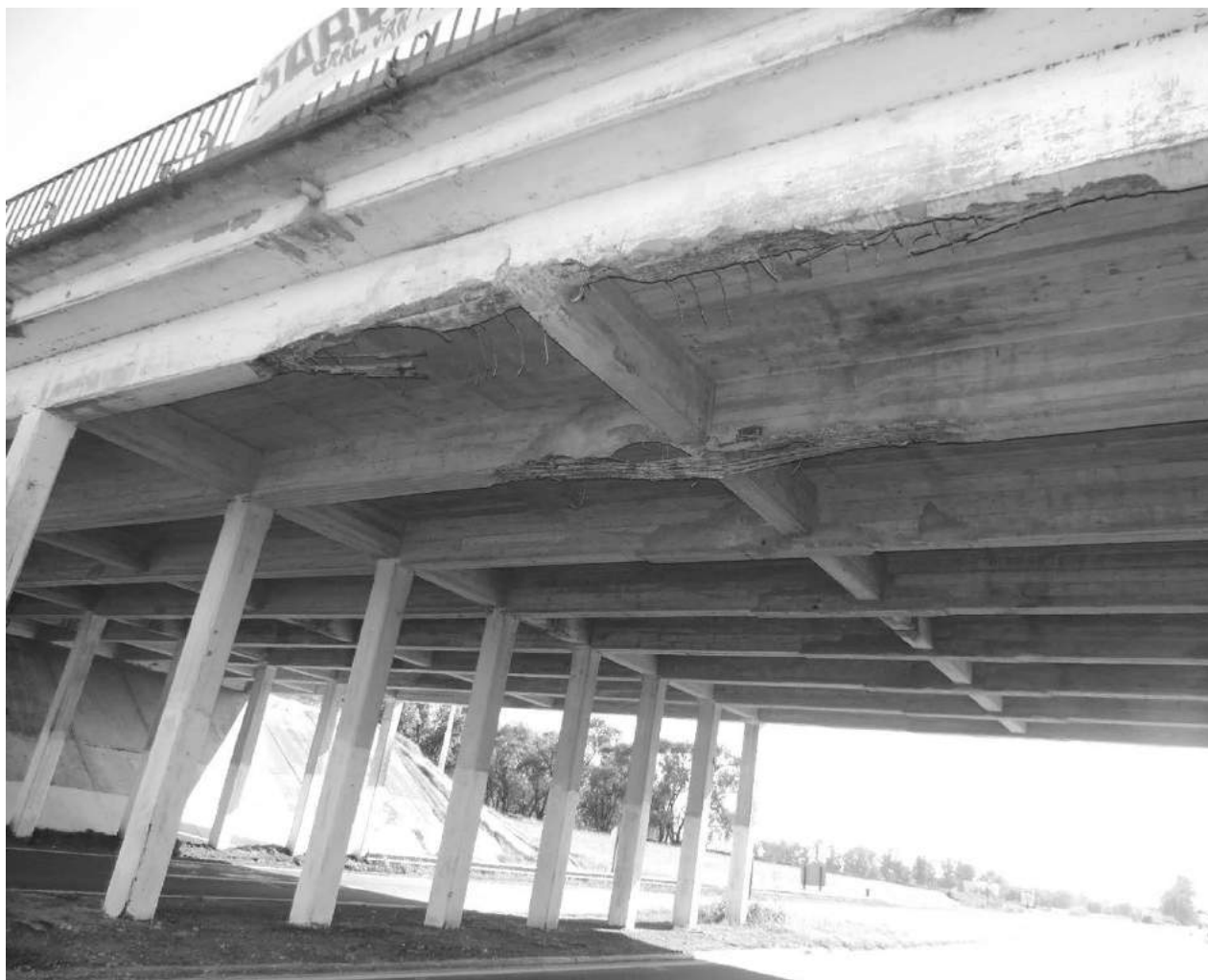
En la fotografía puede observarse la rotura del puente causada por la grúa.
