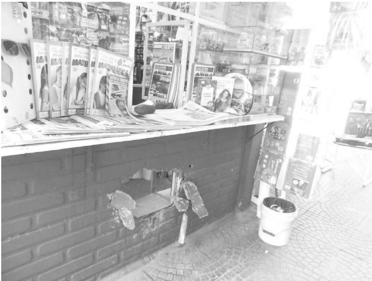
La imagen muestra el daño realizado para ingresar al kiosco.
