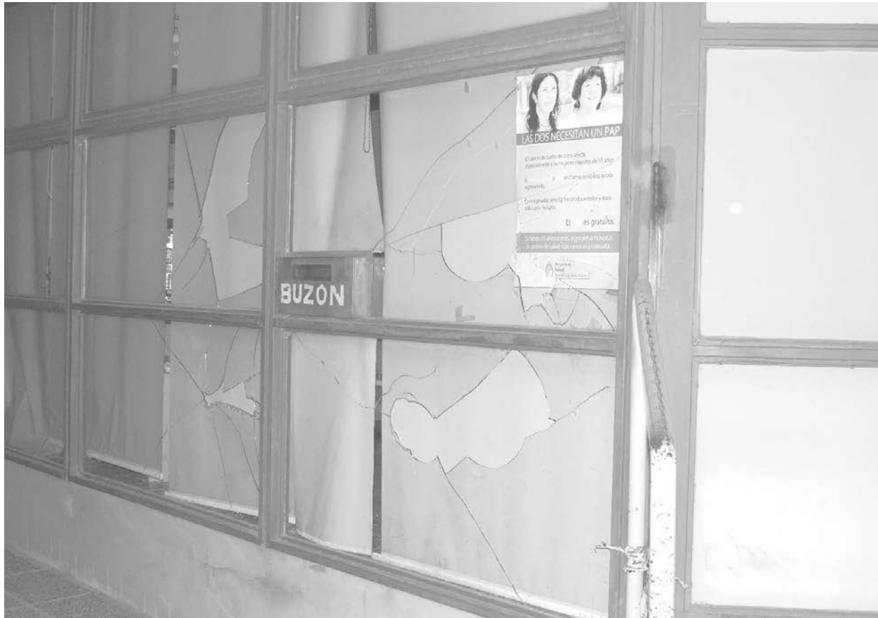
Imagen de los vidrios dañados en la tarde de ayer en el frente de la Cooperativa.
