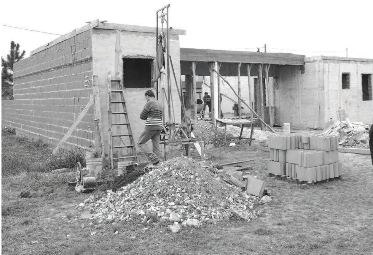
Obra en construcci'on donde se produjo el lamentable accidente ayer.
