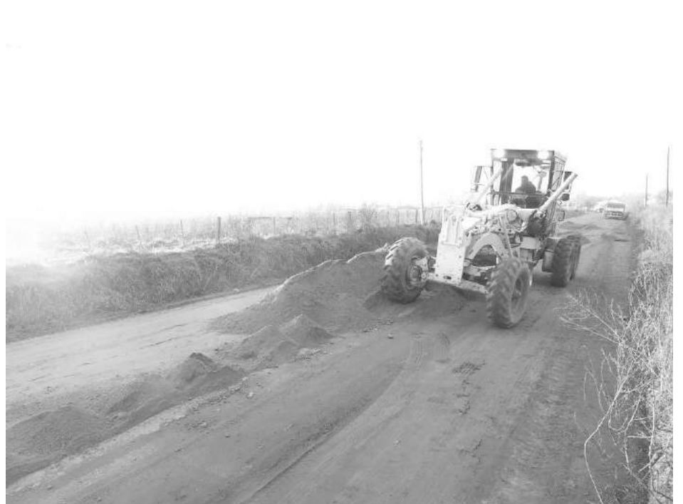
calle Roca hasta Eva Perón, lo que habrá de permitir hormigonar para antes de fin de
