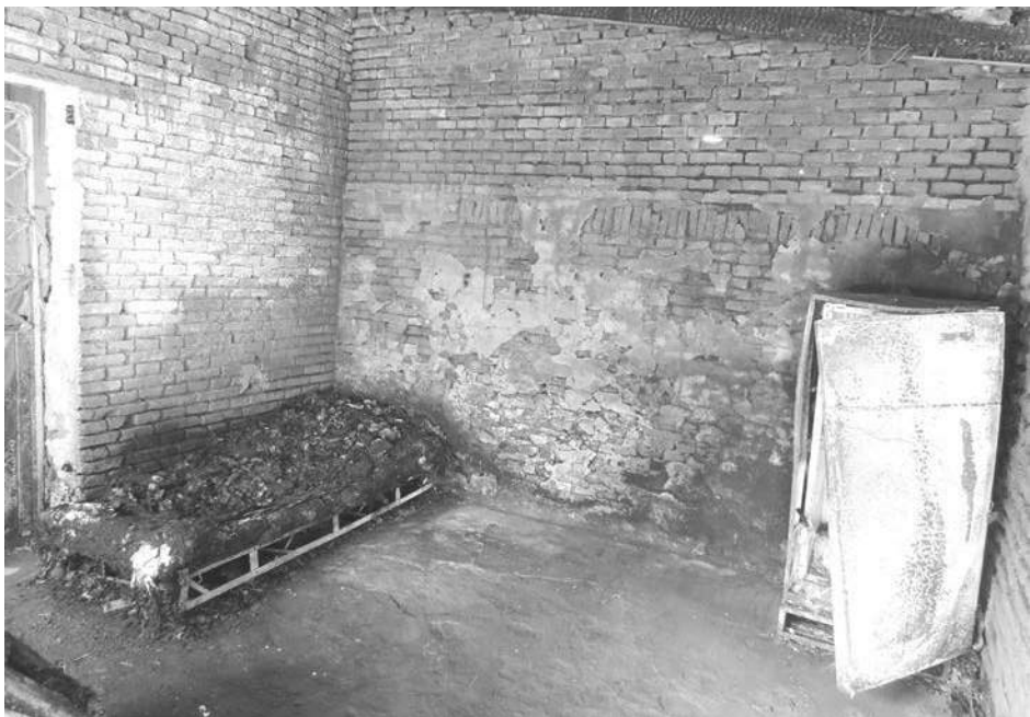
La heladera y una cama destruidas por el siniestro registrado. Fotos De Sogós.
