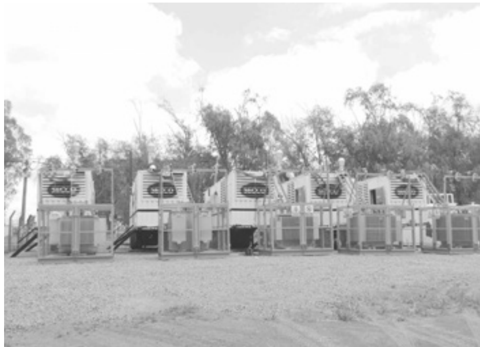
Los cinco nuevos generadores ya están conectados a la red. Fotos De Sogos.
