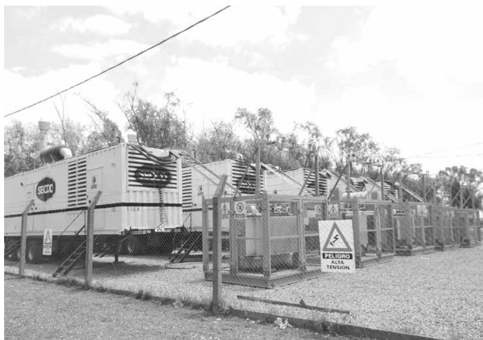
Los nuevos generadores ya están listos para la puesta en marcha. Foto De Sogós.
