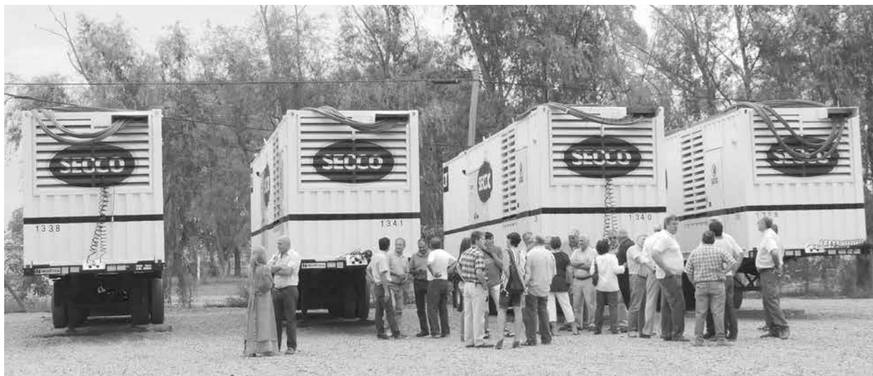
Los cuatros generadores hubicados en el obrador de la CEyS. Foto: DeSogos.
