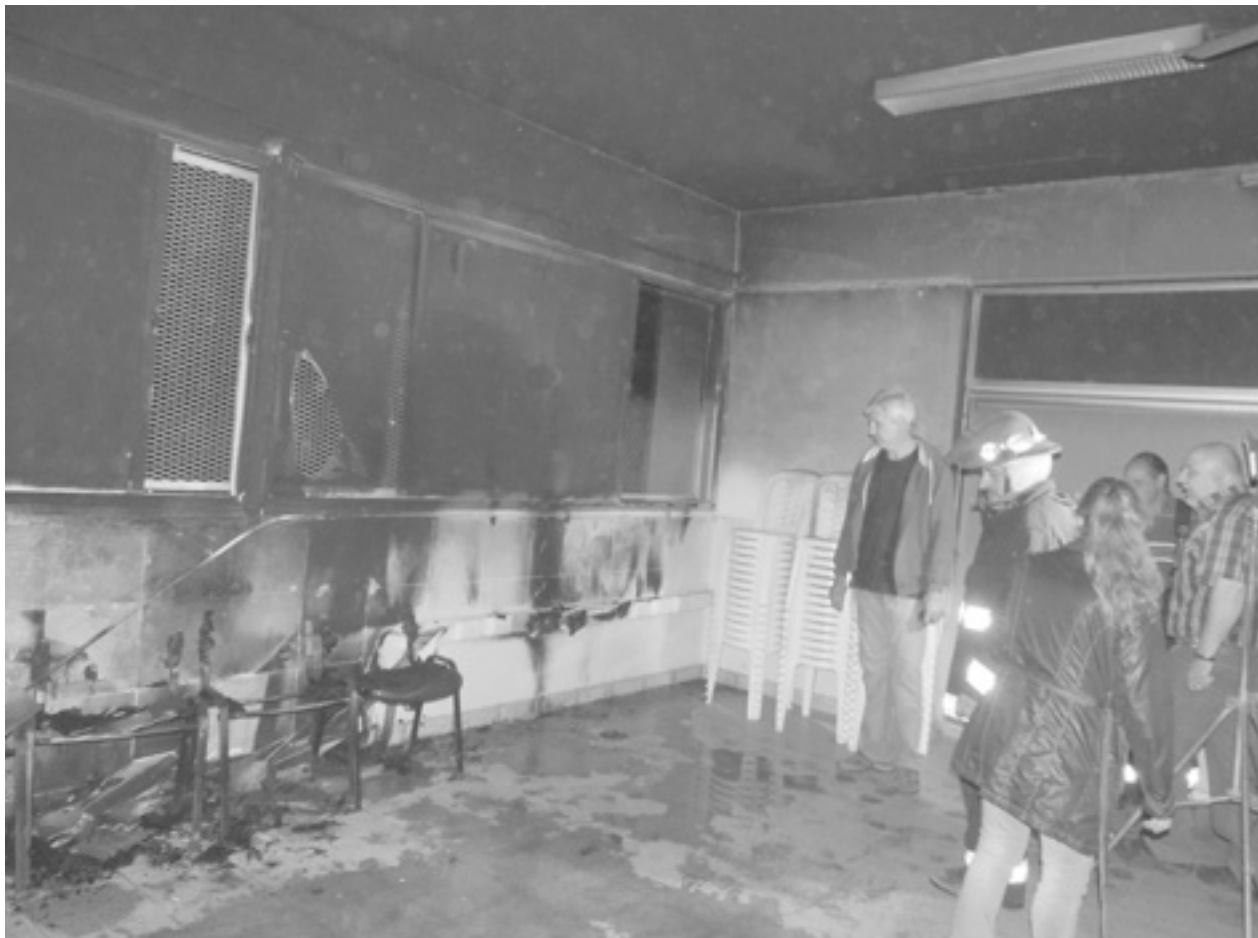
Serios daños sufrió el aula de informática por la acción del fuego, el calor y el hollín.
